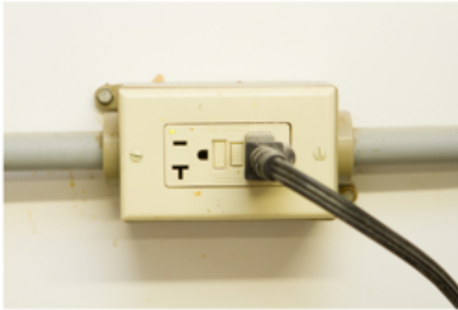
Interrupor de circuito de falla a tierra (GFCI)
