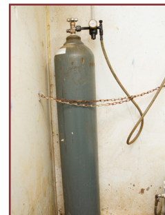
Secured gas cylinders Los cilindros de gas almacenados de forma segura
