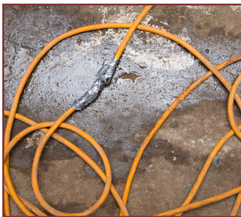
Taped extension cord Cable de extensión reparada con cinta
