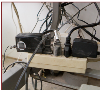
Overloaded electrical outlet Enchufe eléctrico sobrecargado
